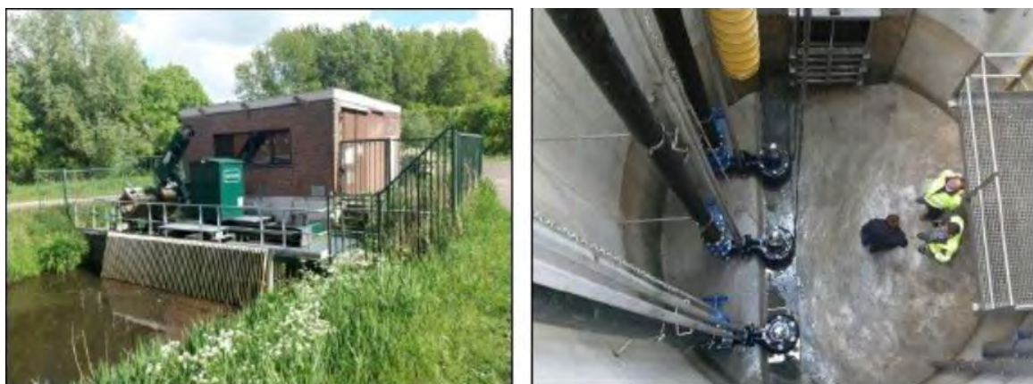
Figuur 61: Pompemaal in polder van Sinaai-Daknam. Bron: VVWP.
